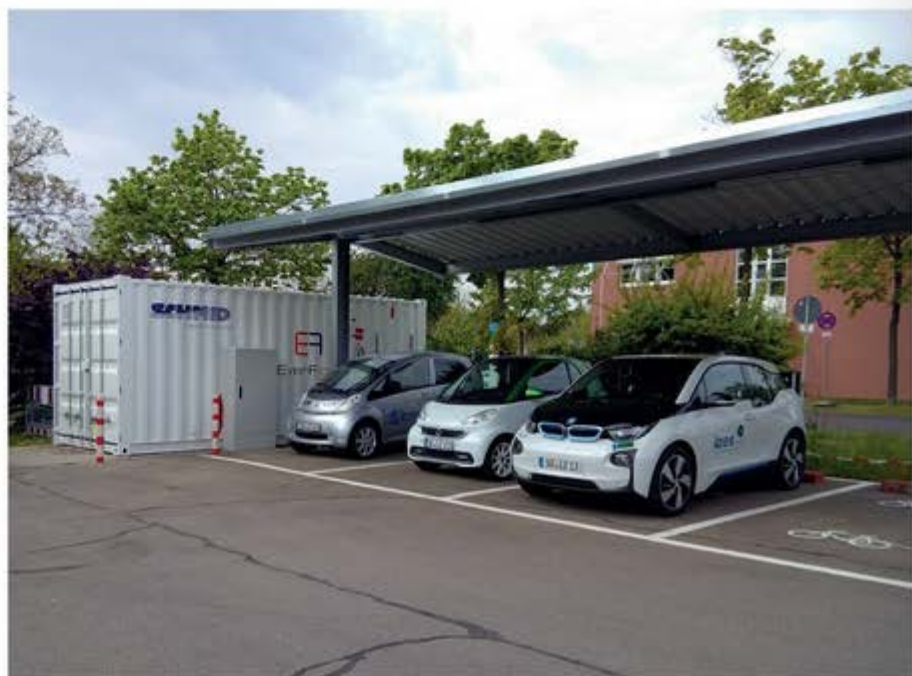
试点工程“OptiCharge”：电动车充电站
