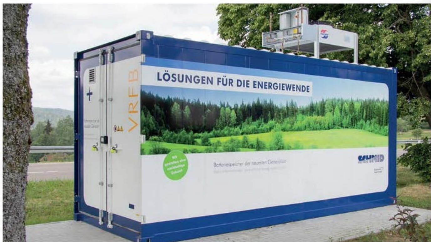
试点工程:EverFlow®储能箱储存由一个热控热电联供装置CHP产生的剩余能量
